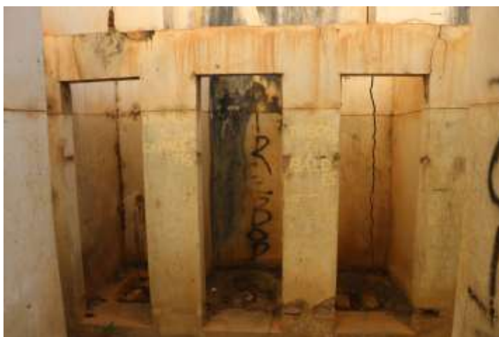
Imagens 65: Vista interna do banheiro dos funcionários. Reminiscências de reutilização em períodos diversos, possivelmente atrelados às intervenções realizadas ao longo dos anos.
