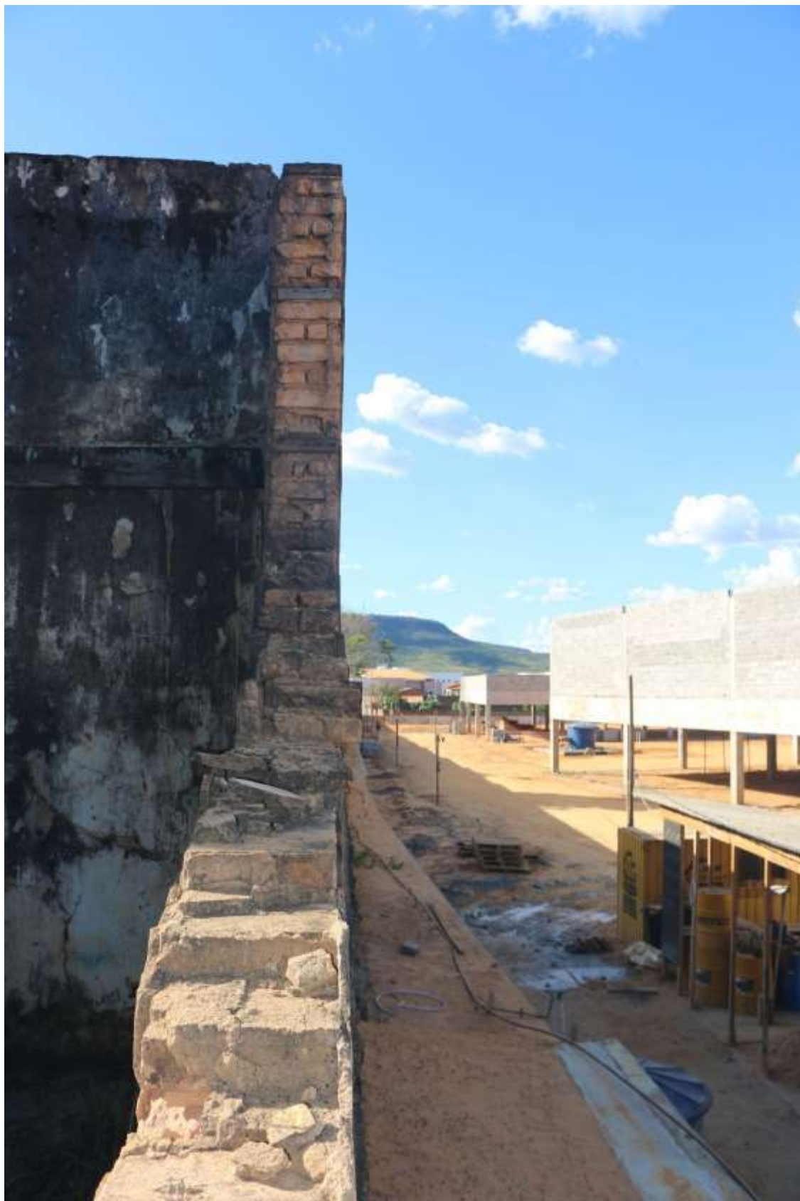
Imagem 43: Vista lateral da Fachada Oeste. Fachada restante completamente interdita para as obras de construção do hospital. Dimensão: 56,58 m 2 .
