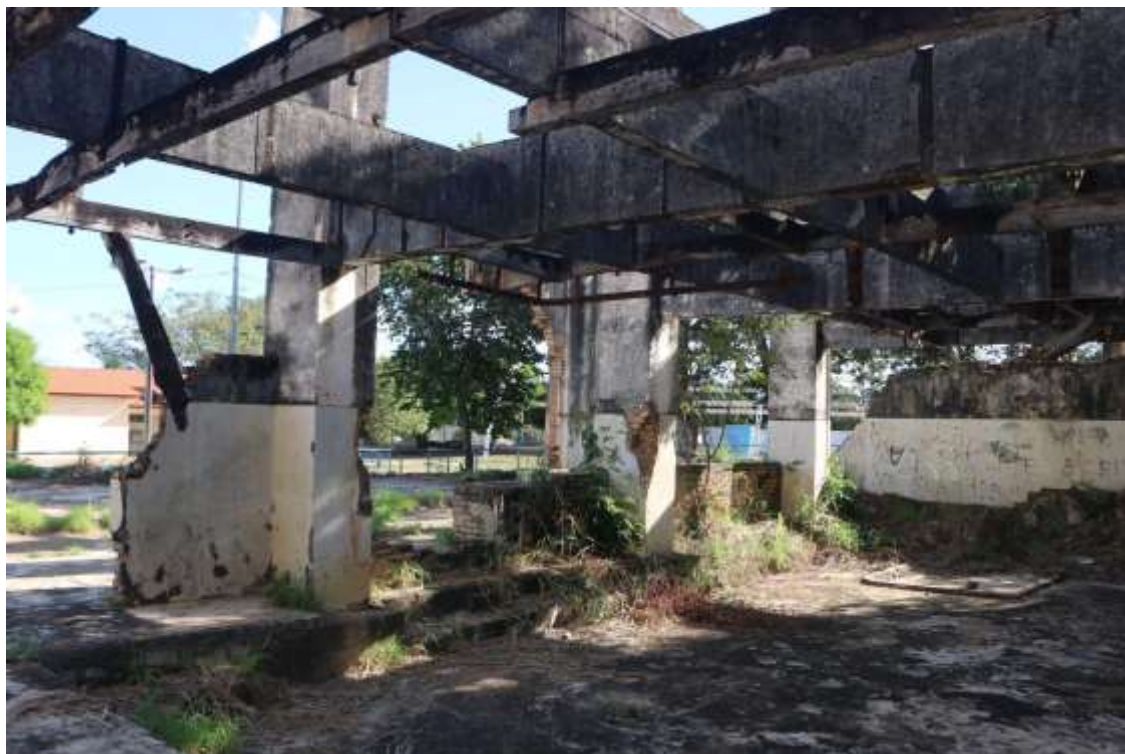
Imagem 52: Vista frontal dos restos da zona de expedição de bovinos, suínos e caprinos. Vestígios da estrutura metálica que dava suporte aos animais para separação. Dimensão: 94,05 m 2 .
