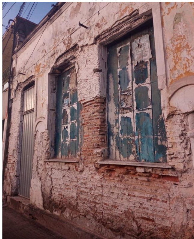
Figura 15 – Ruínas de Santo Amaro. Av. Viana Bandeira, nº não identificado (entre 104 e 110), Bonfim, Santo Amaro-BA
