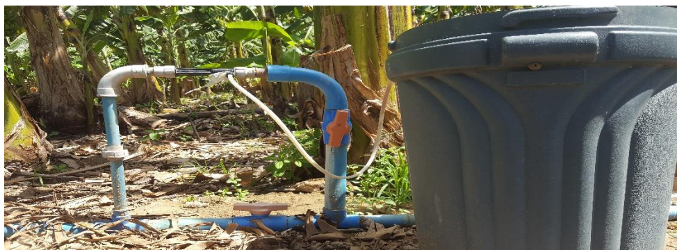
Figura 3. Injetor do tipo Venturi utilizada para a fertirrigação.
