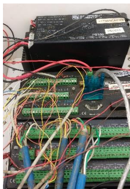
Figura 5. Sistema de aquisição e armazenamento de dados.
