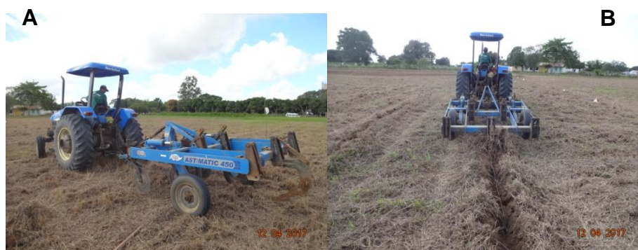
Figura 3. Preparo reduzido com subsolagem na linha de plantio a uma profundidade de corte de 0,60 m.
