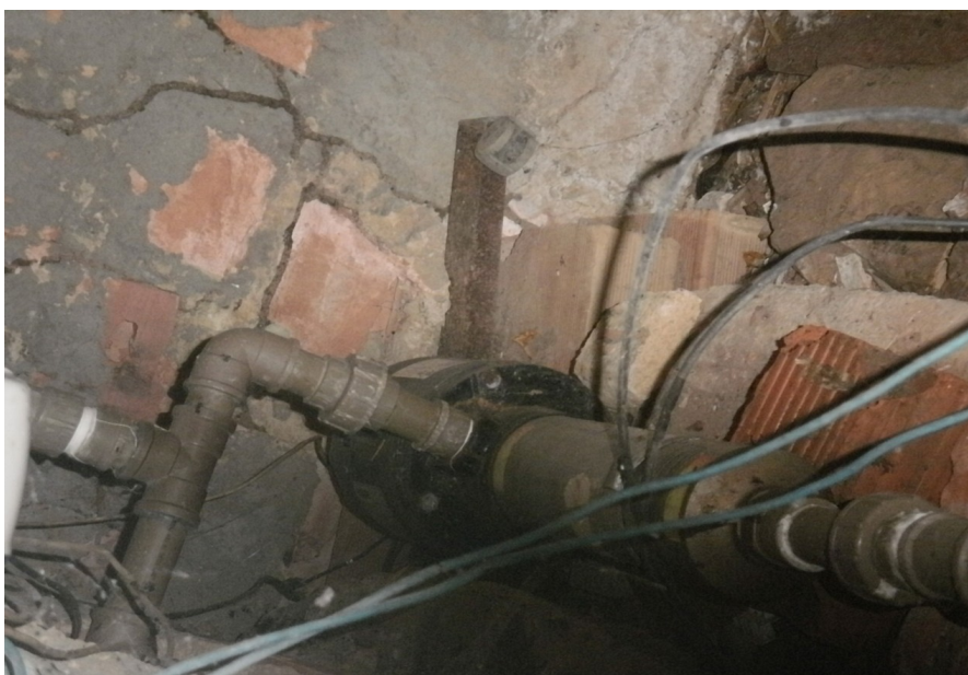
Fotografia 32: Bomba de água em propriedade particular.
