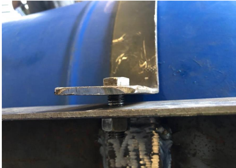
Figura 18. Montagem de boia flutuante: fixação de parafuso inadequada
