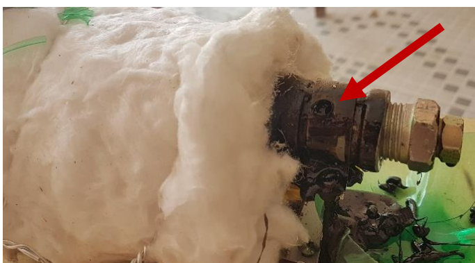
Figura 4.10 – Local de vazamento do material.
