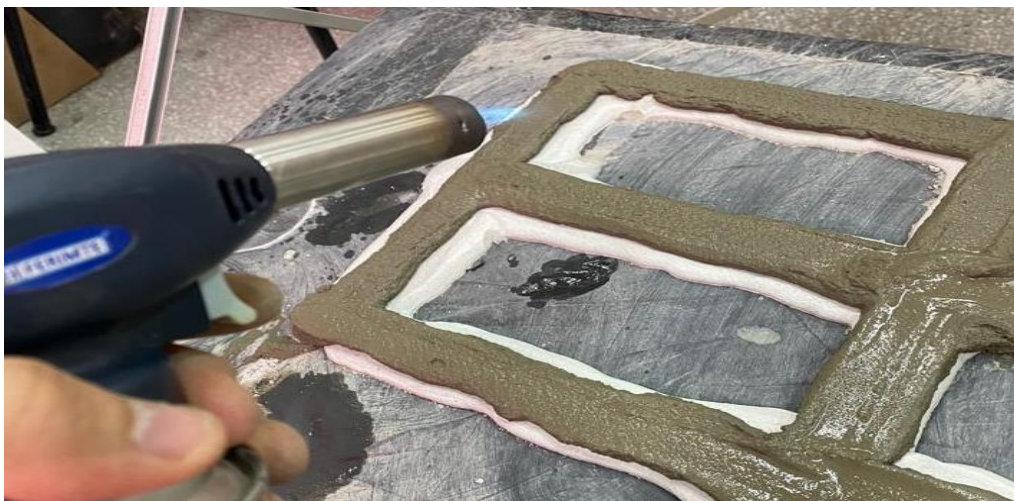
Figura 71. Utilização do maçarico para remoção parcial da umidade a fim de sobrepôr mais camadas .
