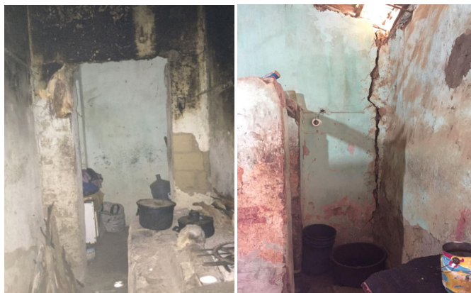
Figura 15 – Parede com fuligem. Figura 16 – Trinca na parede.
