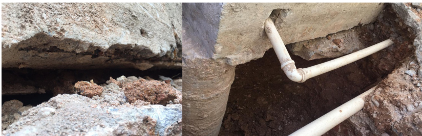
Figura 5 - (a) Exposição da armadura das vigas baldrame (b) redução da seção e excentricidade de carregamento.
