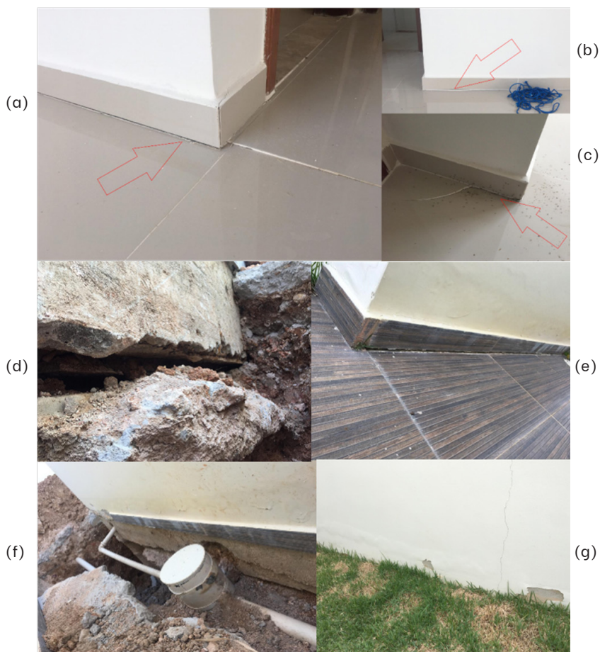
Figura 6 - Destacamento da alvenaria devido o deslocamento vertical do solo na área interna (a, b e c) e na área externa da edificação (e); Recalque na base dos elementos estruturais (d e f); e problemas associados a falta de impermeabilização da alvenaria (g)
