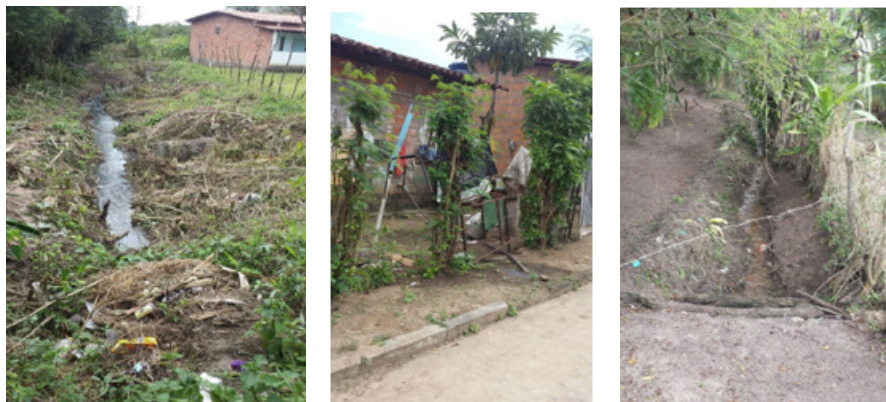
Drenagem de águas cinza e esgotos a céu aberto.
