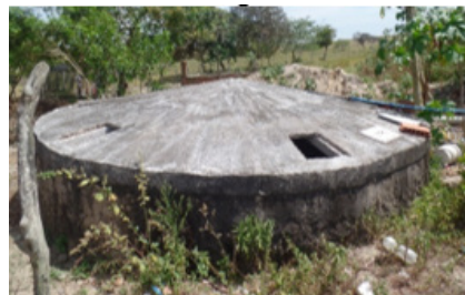
Cisterna de água de chuva
