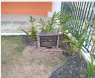
Imagem hidrômetro instalado
