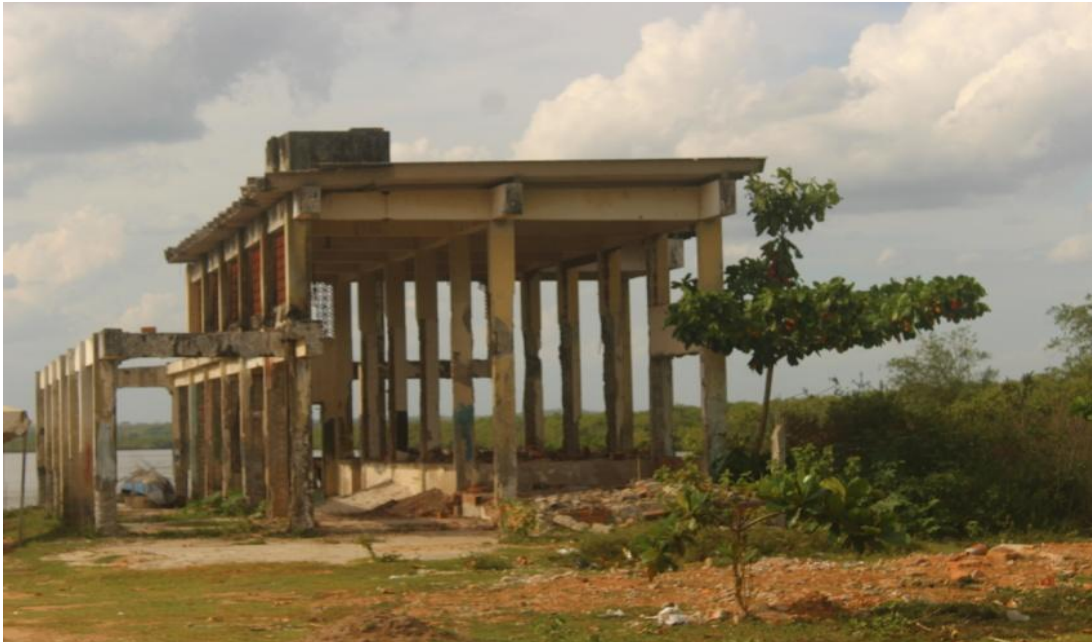
Figura 18: as ruínas da casa de farinhas na rua do cais de São Bento.
