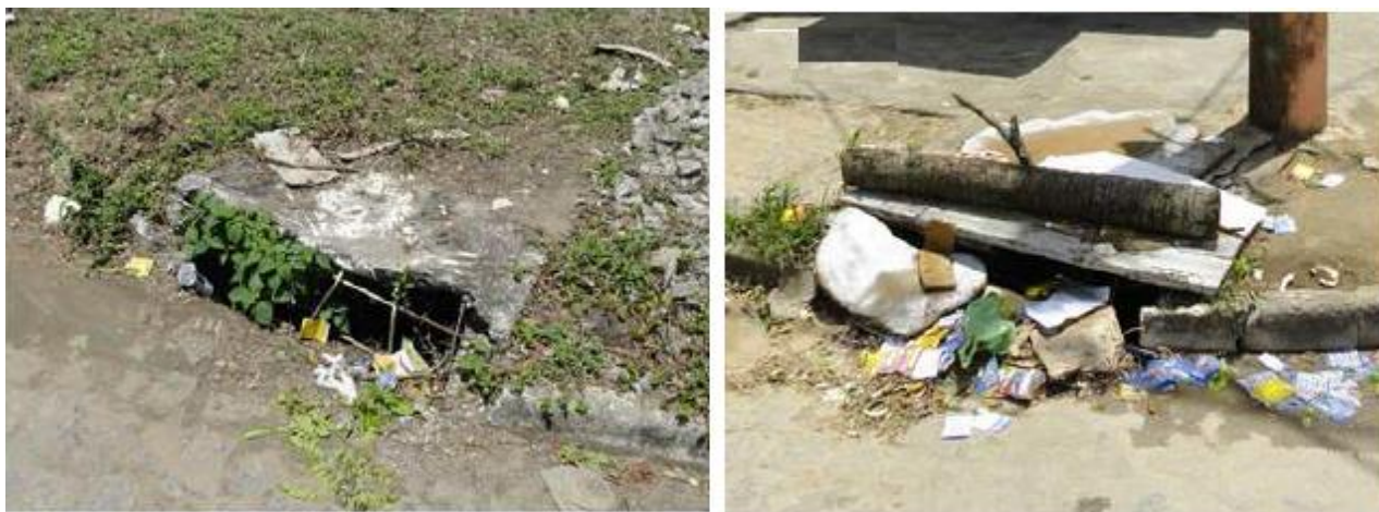
Foto 14 - Bocas de lobo sem manutenção (rua Aderbal S. Oliveira)
