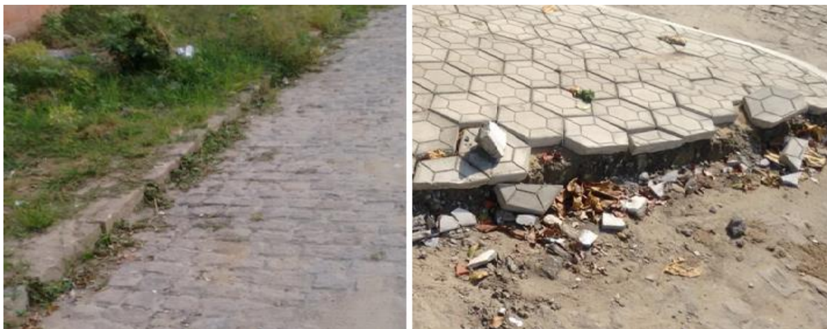
Foto 13 - Sarjetas sem manutenção
