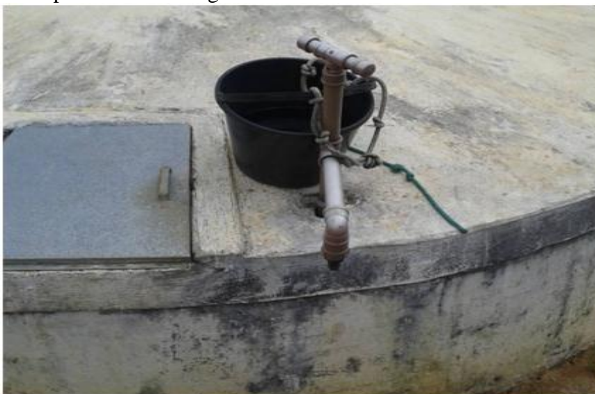
Figura 98 – Balde para retirada de água da cisterna
