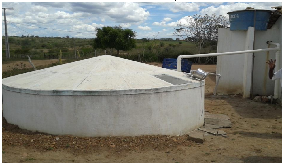
Figura 91 – Cisterna de Placa na zona rural de Santanópolis
