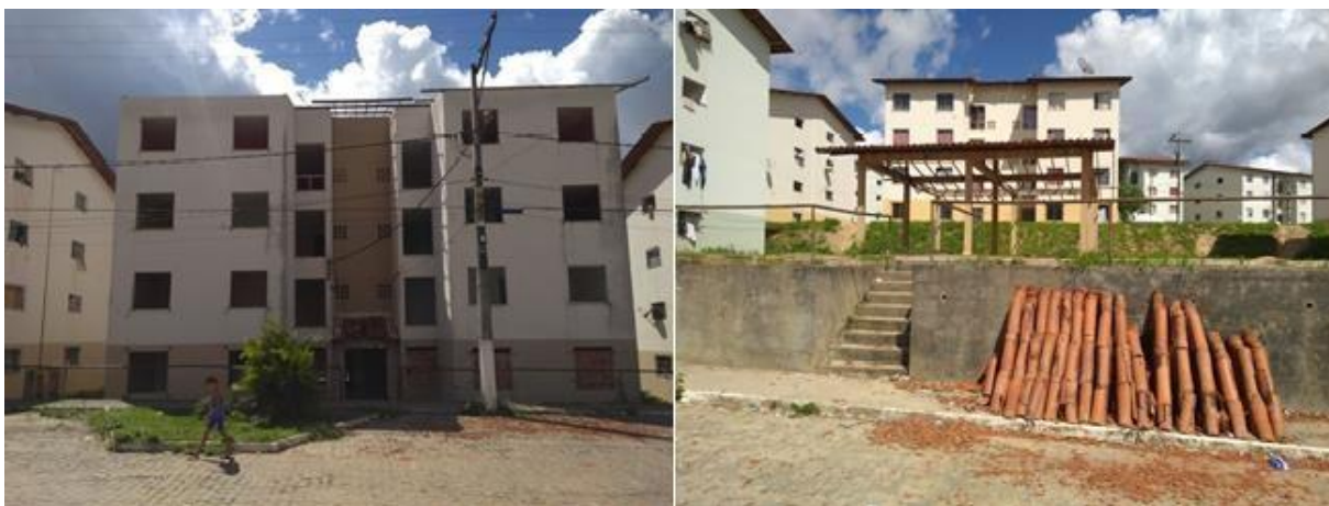
Figura 3 - Bloco 002 interditado por problemas estruturais e telhas retiradas deste para transformação do quiosque na associação
